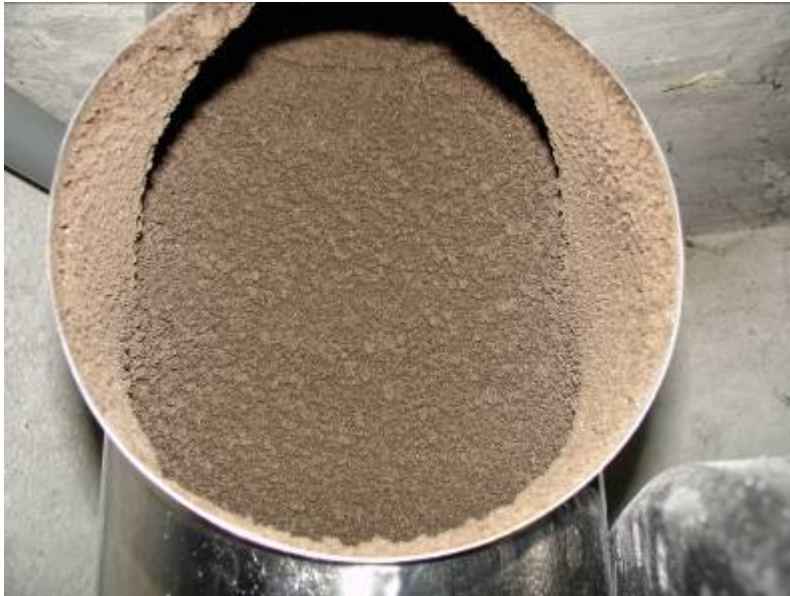
Russablagerung Rauchgasrohr Beispiel Roveredo
