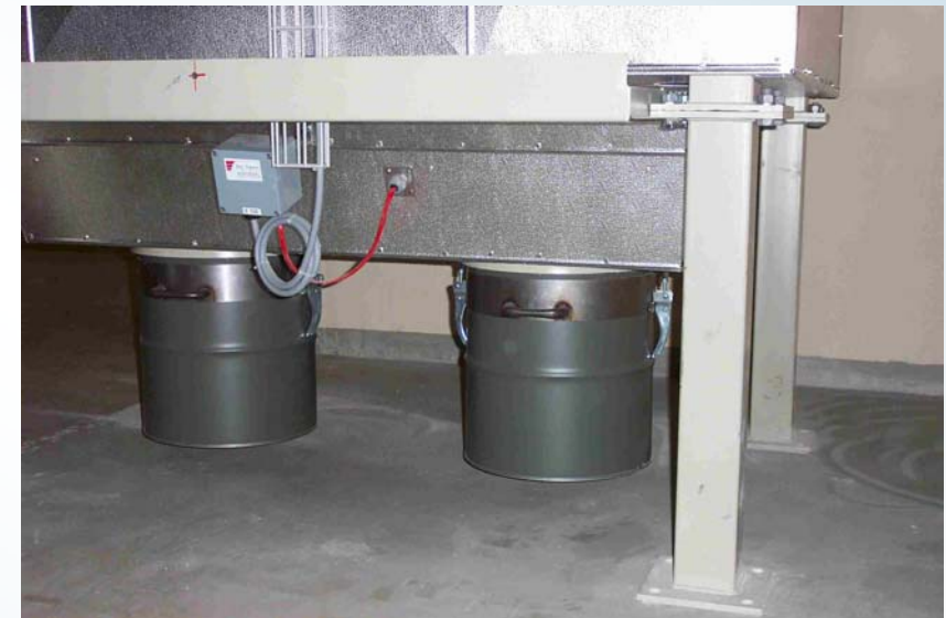
Bunkerbeheizung am Mini-Elektrofilter
